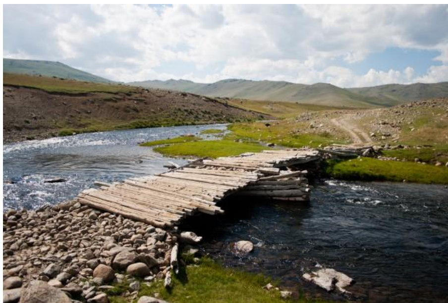
Фото № 65 Полуразрушенный мост
